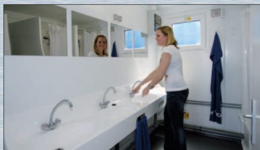
Sanitaire container (binnenzicht)
